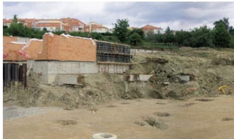
Obr. 1 Situace na staveništi; během zemních prací došlo ke vzniku sesuvu ve zvětralých vysoce plastických jílech.
