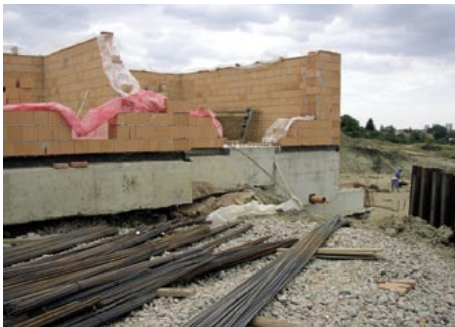
Obř. 3 Ztekucený jíly „odtekly“ zpod základové spáry, konstrukce zůstaly stát pouze na pilotách.
