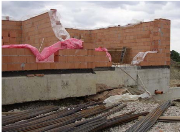
Obr. 1) Pohled na základovou spáru jednoho z vícepodlažních domů (došlo k „vytečení“ jílu v místě základové spáry) (Štábl, Vlček a Poul 2005).
