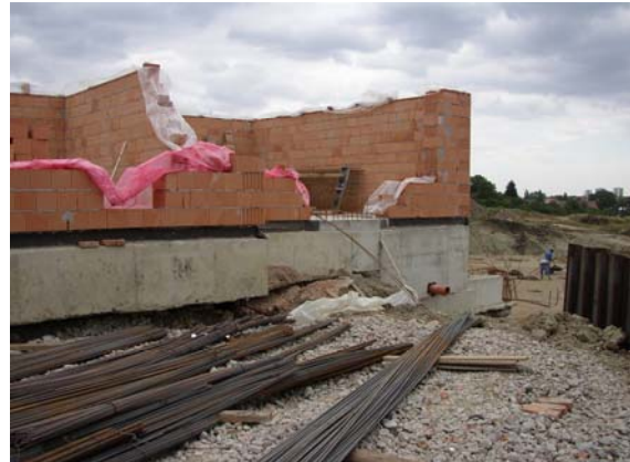
Obr. 3: Plastické jílly „odtekly“ zpod základové spáry, konstrukce zůstaly stát pouze na pilotách
