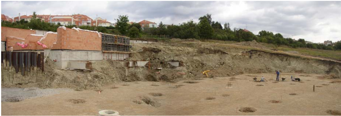
Obr. 1: Situace na staveništi, během zemních prací došlo ke vzniku sesuvu ve zvětralých jílech (F7/F8)
